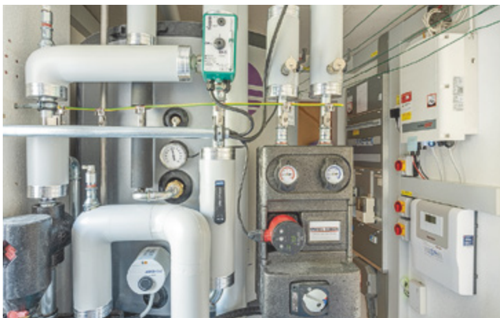
Heizungsanlage mit Wärmepumpe und Warmwasserspeicher.
